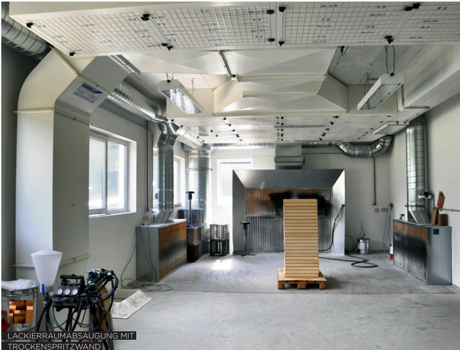
HALLENSCHICHLÜFTUNG MIT WÄRMERÜCKGEWINNUNG
