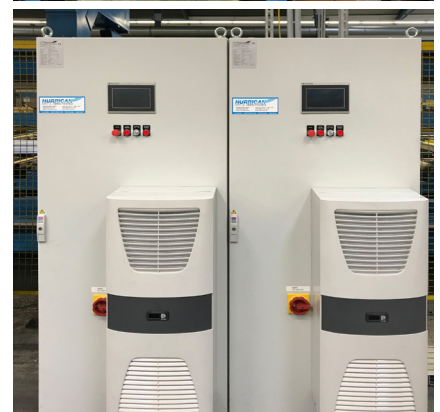
Schalt- u. Steuerschrank mit Kühlung und Touch-Paneel
